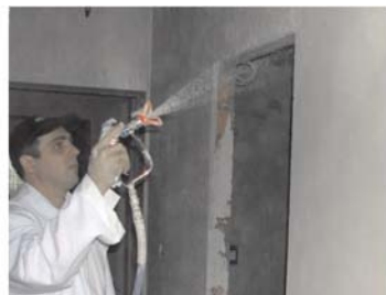
Precizno prskanje Riplana na zidove i plafone pomoću pištolja (airless) bez upotrebe kompresora.
